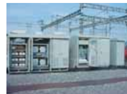
電力補完装置
