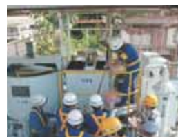
排水水処理装置のメンテナンス
