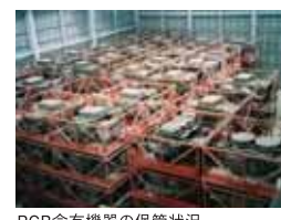
PCB含有機器の保管状況
